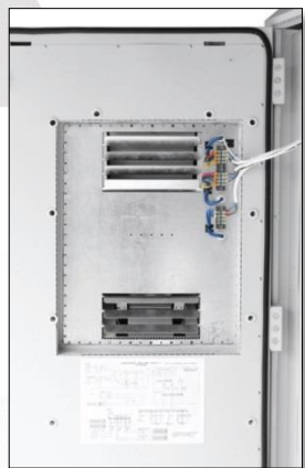
Zuführ- und ablüftungssystem
